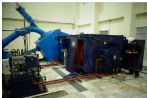
Foto 4. Grupo de turbina - generador en funcionamiento
